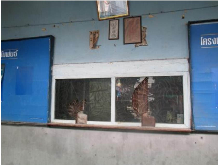
รูปที่ ๔-๘ : สภาพปัจจุบันบริเวณห้องจำหน่ายตั๋วที่ขาดการดูแลรักษา เนื่องจากธุรกิจที่ไม่ได้รับผลกำไร (ที่มา : จากการสำรวจเก็บข้อมูลเดือนมกราคม ๒๕๕๘)
