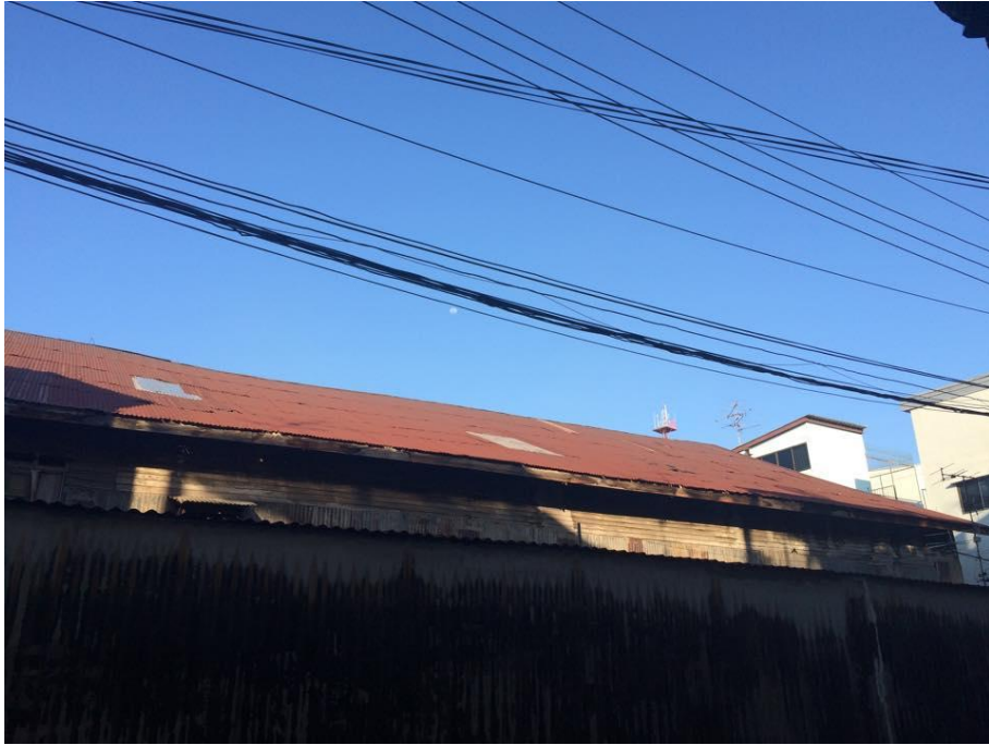
รูปที่ ๔-๑๐ : สภาพหลังคาอาคารศาลาเฉลิมธานี และรั้วอาคารด้านข้าง (ที่มา : จากการสำรวจเก็บข้อมูลวันที่ ๓๑ มีนาคม ๒๕๕๘)
